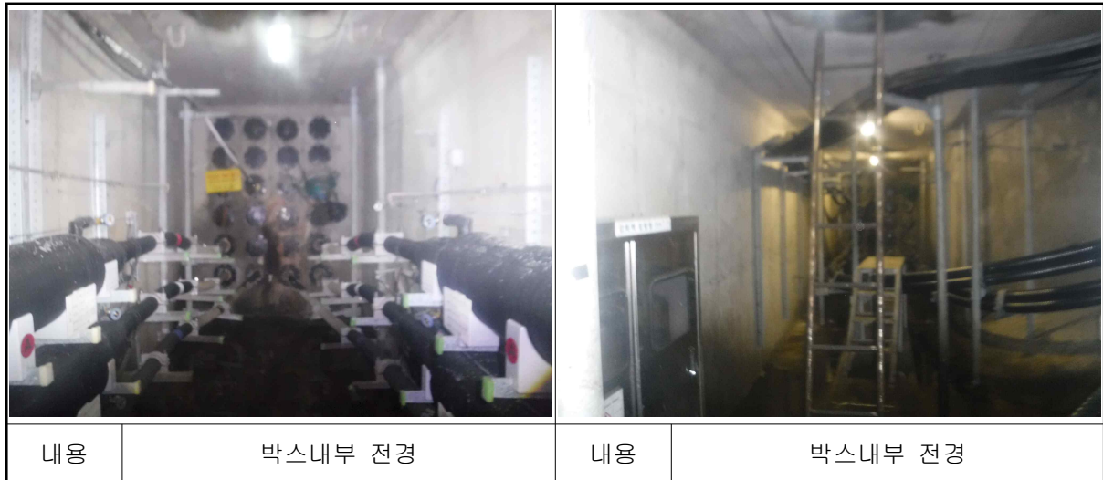
【사진 4.1】 능곡S/S인출 전력구 현황
